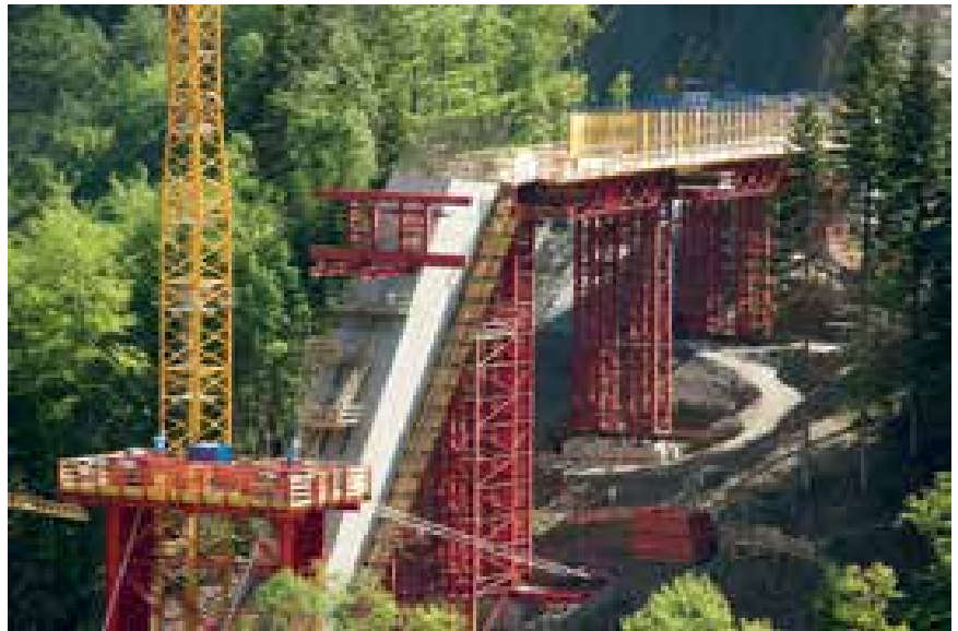
13 Traggerüst im Randfeld auf der Seite Pfäfers © Leonhardt, Andrä und Partner AG
