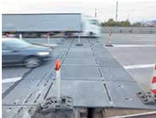
■ Modular Bridging System mit überfahrbaren Stahlplatten © Maurer AG/Erik Krüger
