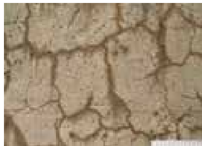
AAR-bedingte Risse im Beton © Empa/Andreas Lehmann
