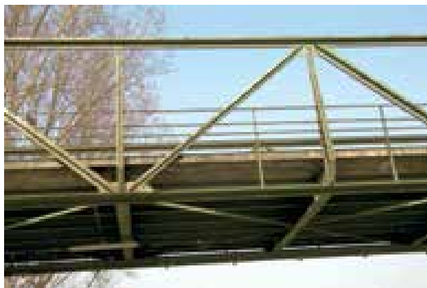
6 Betonschäden an der Stahlbetonfahrbahnplatte © Büchting + Streit AG
