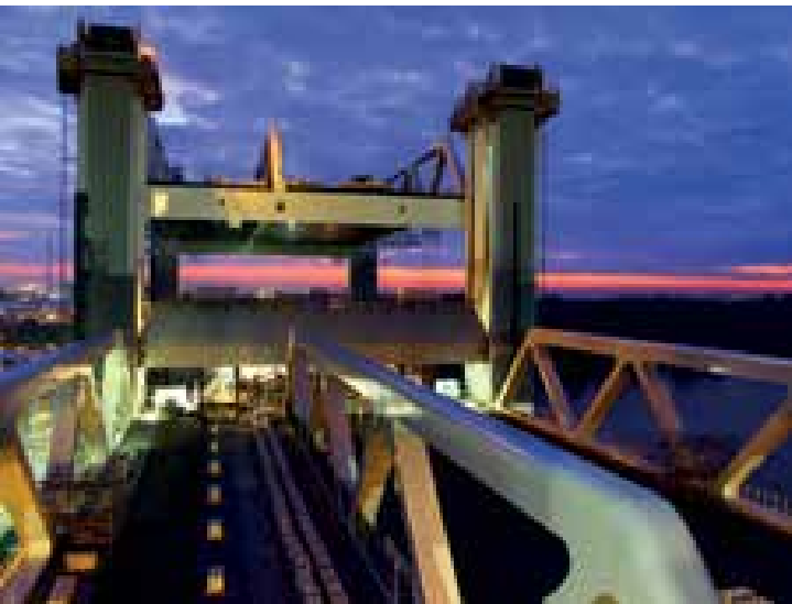
34 Erstes Brückendeck nach dem Einheben, zweites vor dem ersten Hub © Waagner-Biro Bridge Systems AG
