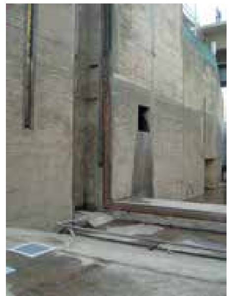
Erscheinungsbild der alten, korrodierten Hartauflagerung © Diamant Metallplastic GmbH
